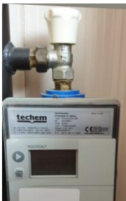
Meetpunt centrale verwarming
